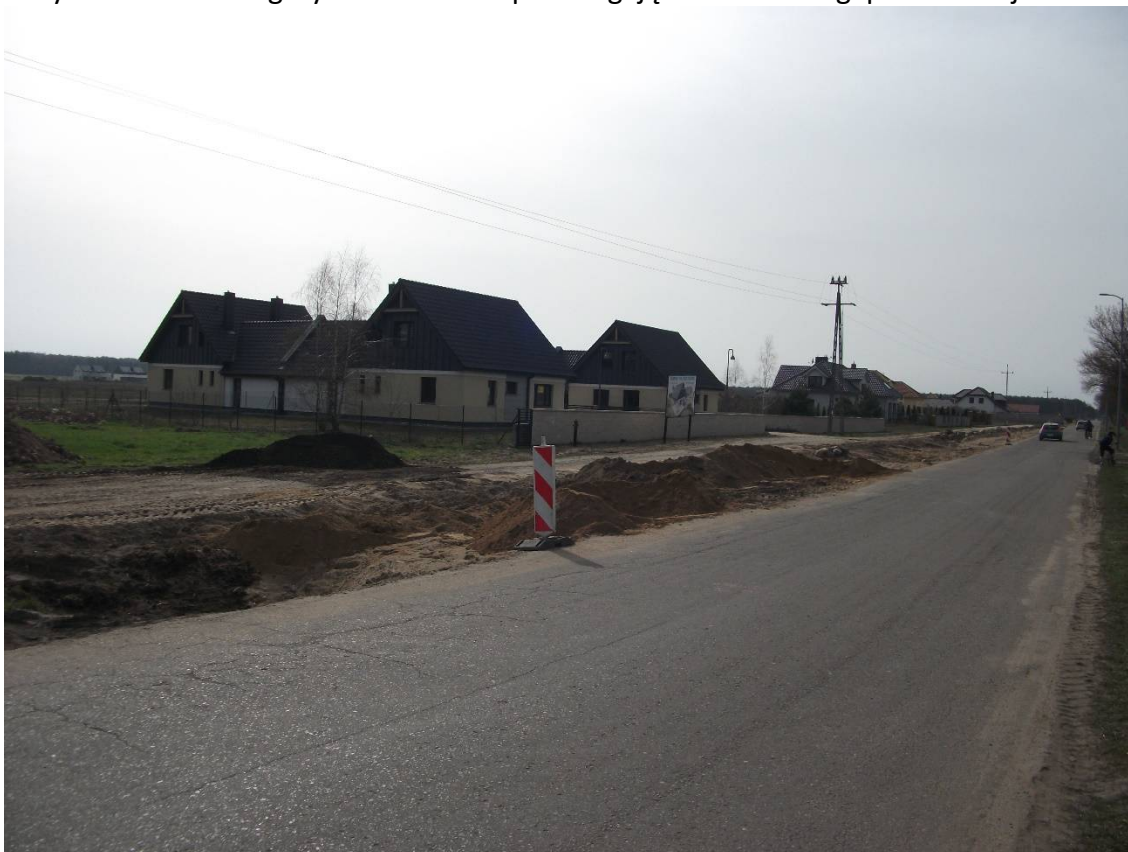
Ryc. 15. Linia energetyczna SN 15 kV przebiegająca wzdłuż drogi powiatowej 4801P
